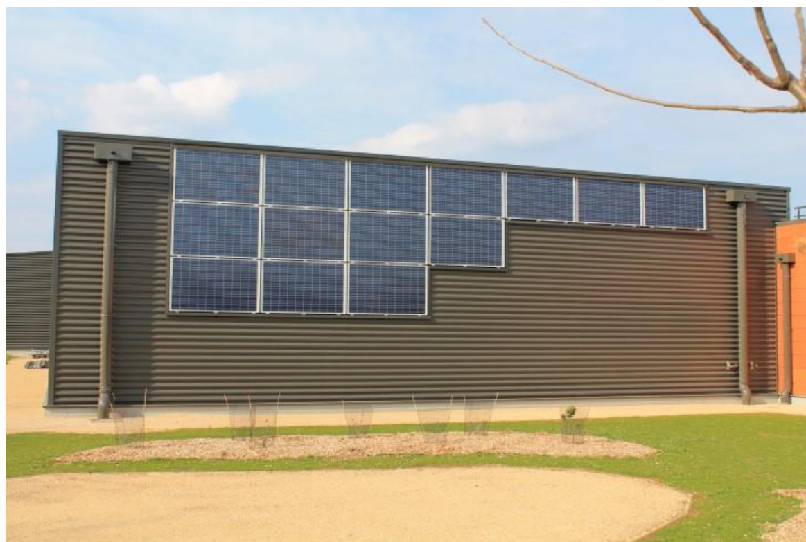
Modules photovoltaïques intégrés à la façade et en toiture
