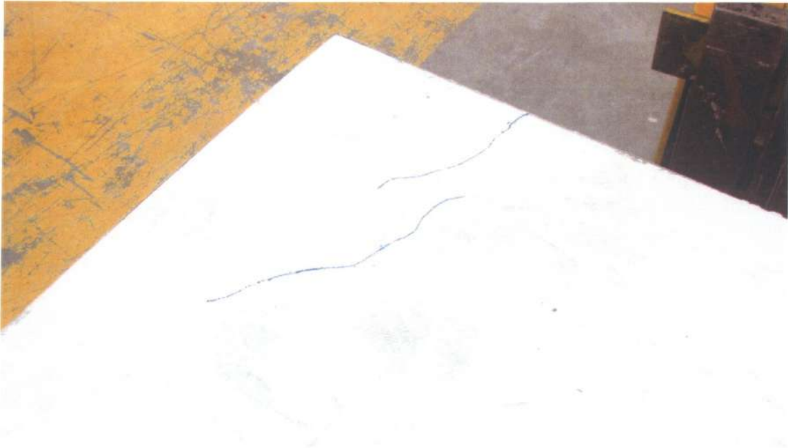
Photo 36 : Détail de la fissuration au niveau de l'appui fixe
