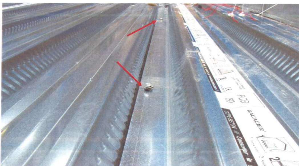
Photo 18 : Détail de l'arrachement des vis de couture
